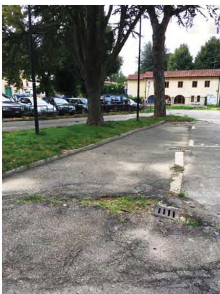
Immagini del degrado delle pavimentazioni e del sistema di smaltimento delle acque
