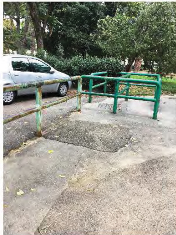
Tornello da sostituire
