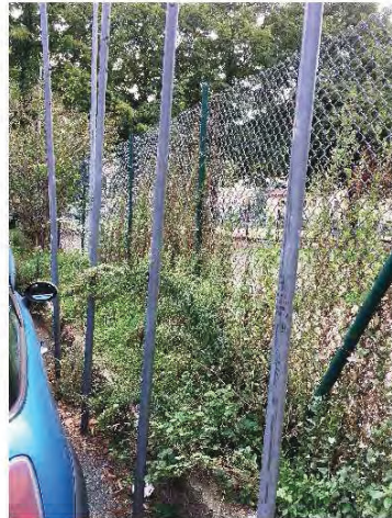
Recinzione a maglia sciolta da sostituire con balaustra
