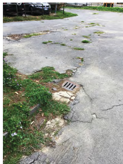
Immagini del degrado delle pavimentazioni e del sistema di smaltimento delle acque
