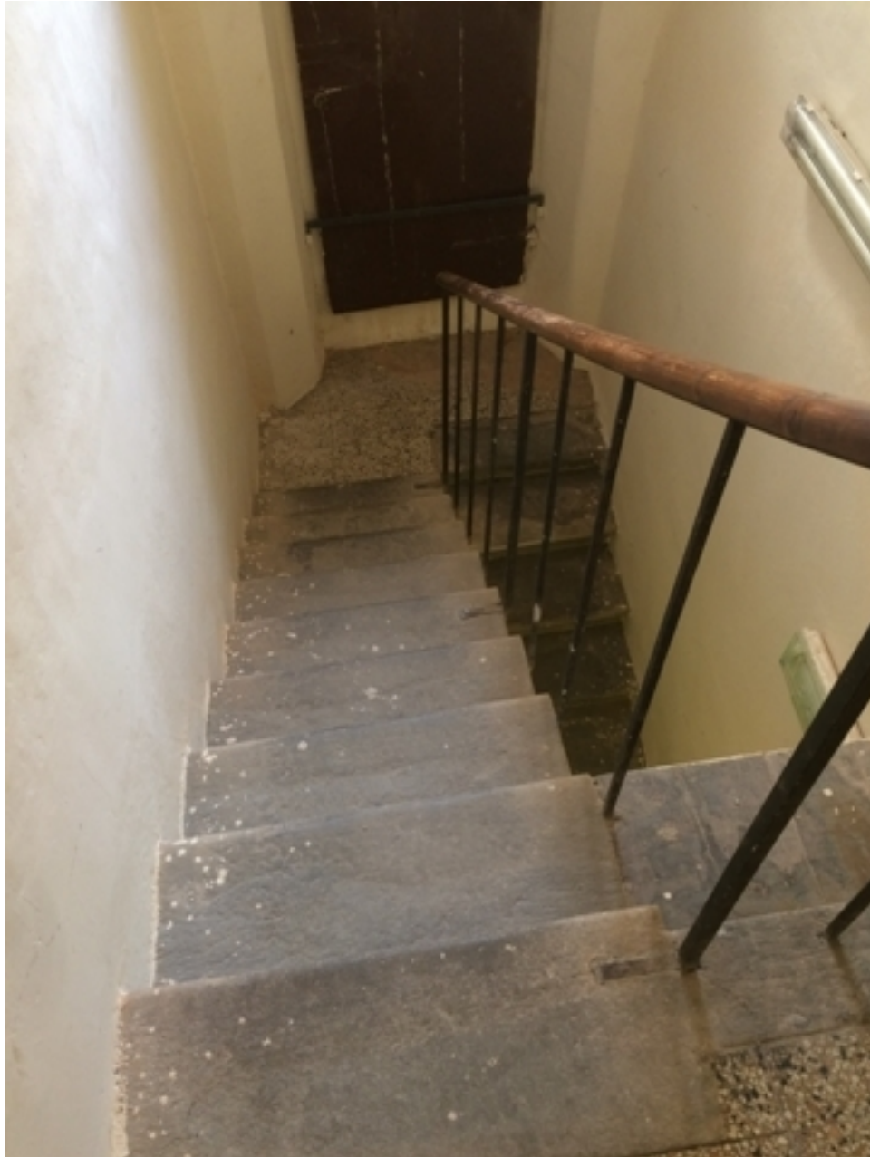
6. scala di accesso ai locali archivio del piano ammezzato passando dal secondo piano
