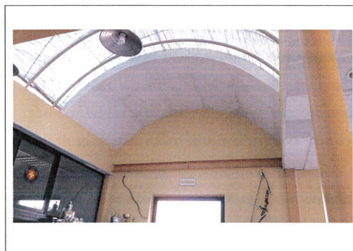
Infiltrazioni Zona bar/ristorante/ufficio – lato ufficio
