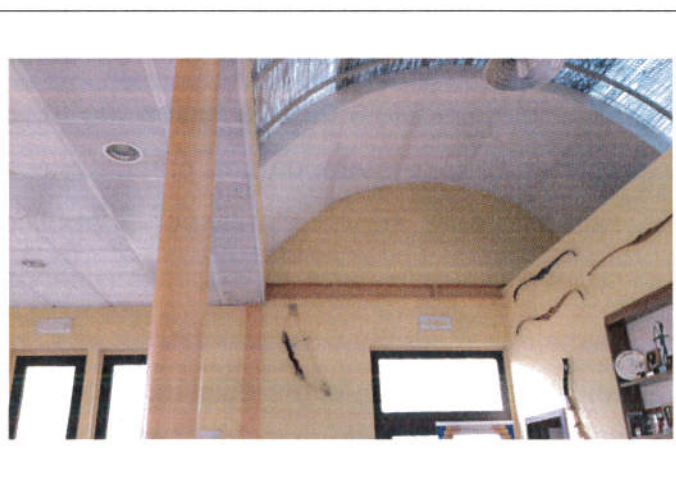
Infiltrazioni Zona bar/ristorante/ufficio – lato cucina
